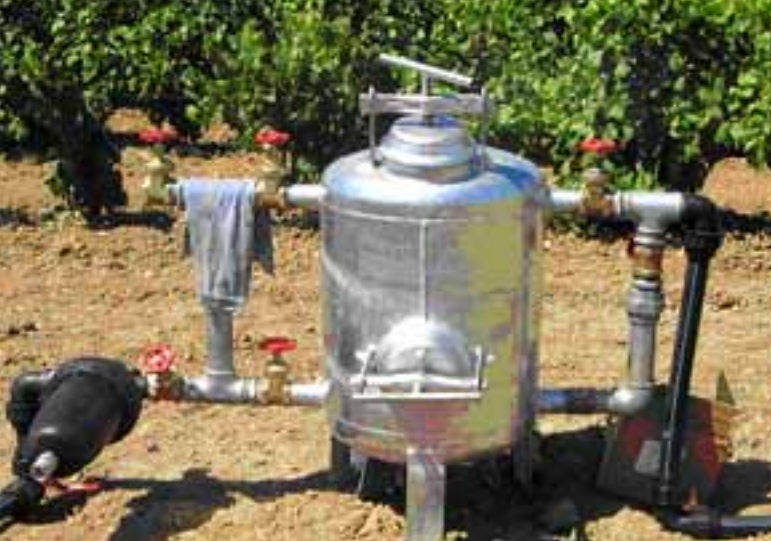
Foto 3: Stazione filtrante composta da filtro a sabbia e filtro a dischi
