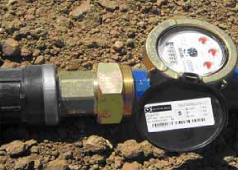
Foto 7: contatore volumetrico installato nella condotta di settore
